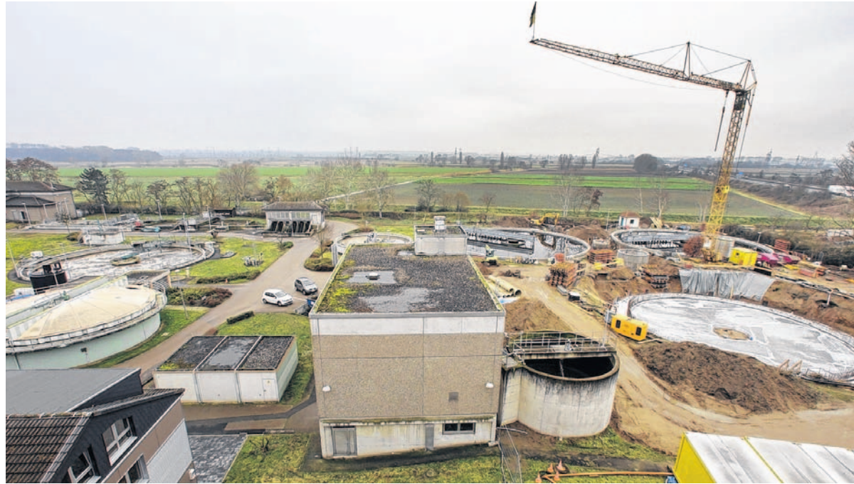
Großer Ausgabeposten im Haushalt: In diesem Jahr fließen 900.000 Euro in die Erweiterung des Klärwerks. Die Anlage erhält ein drittes Nachklärbecken. Die Arbeiten sind in vollem Gange. BILD: LENHARDT
